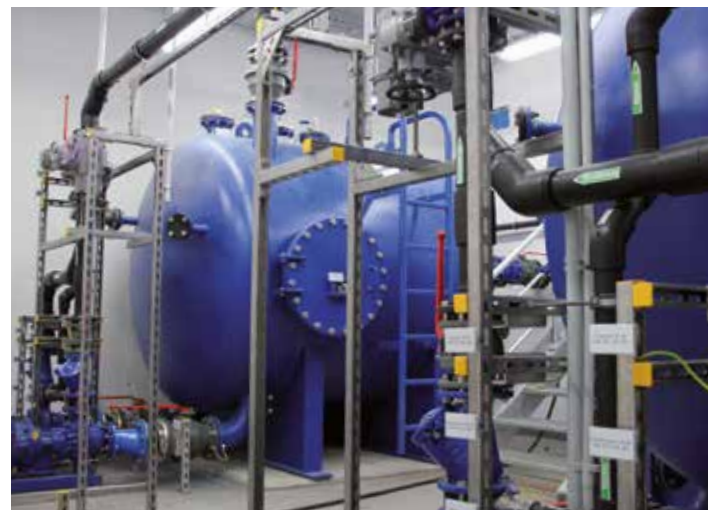
Vakuumstation im Betriebshof
